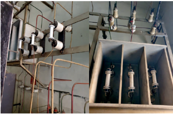
Sezionatori e fusibili MT
