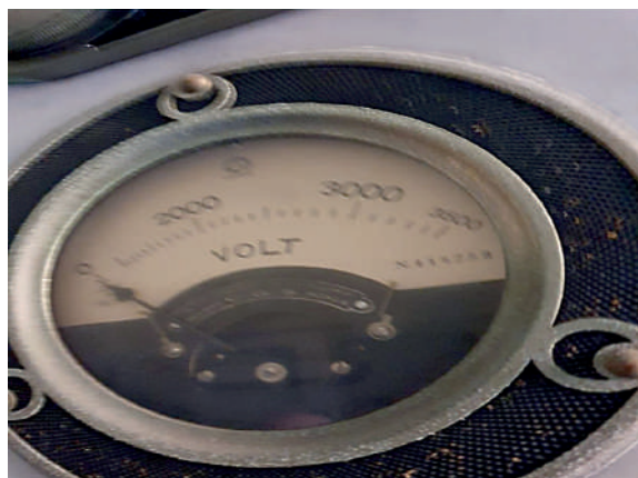
Il voltmetro è alimentato dal riduttore di tensione (TV) ed ha un fondo scala pari a 3.500 Volt
