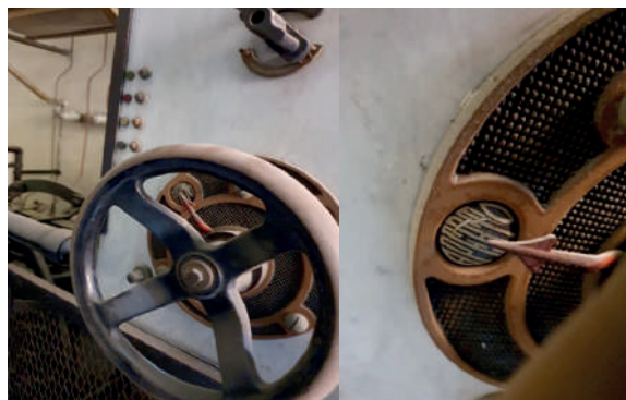
Interruttore generale lato 3.000 Volt
