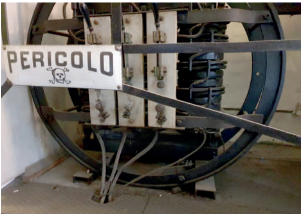
Particolare: cartello monitor, coltelli di sezionamento e fusibili lato Bassa Tensione
